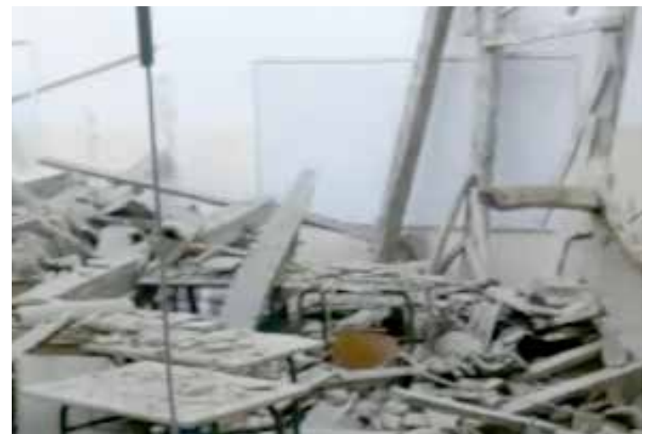
Il soffitto totalmente crollato della scuola di Fermo
