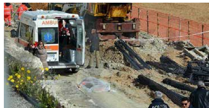
Crotona, aprile 2018. Il soccorso porta via i corpi dei due operai morti durante i lavori a un muro sul lungomare
