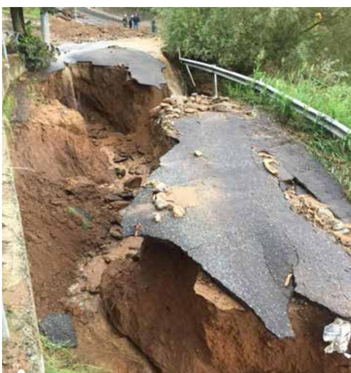
Tra i tanti danni del maltempo in Calabria anche il crollo della strada statale 110 nel Vibonese
