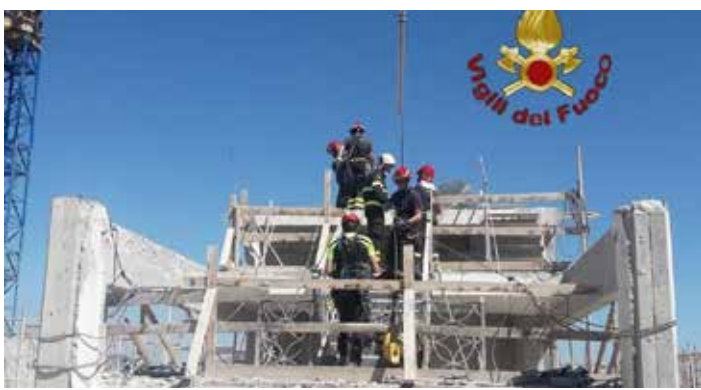
Roma. I pompieri al lavoro su una struttura in cemento dove hanno perso la vita due operai edili
