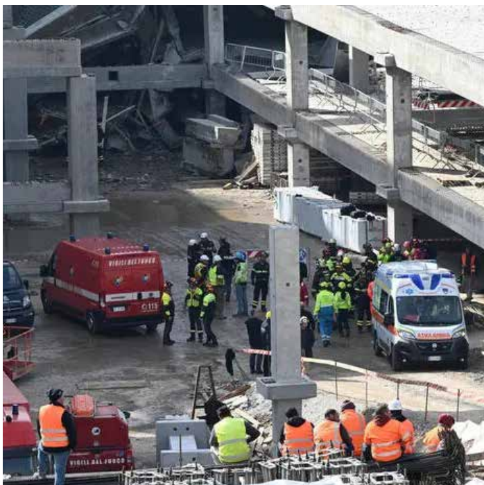
Firenze 16 febbraio 2024. Una immagine del cantiere Esselunga dopo il crollo che ha provocato la morte di 5 operai
